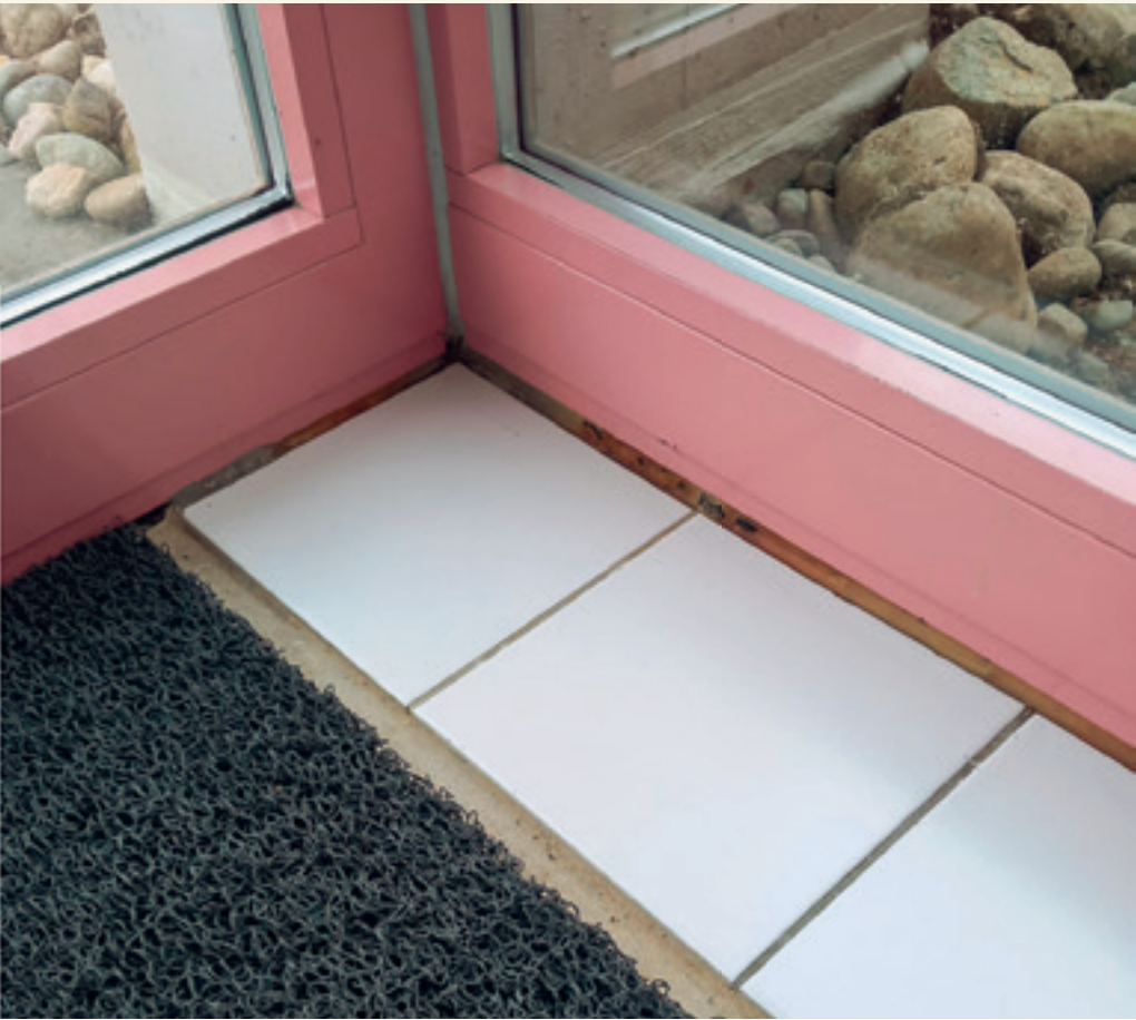
Silikonverfärbung durch Bitumenkontakt.
