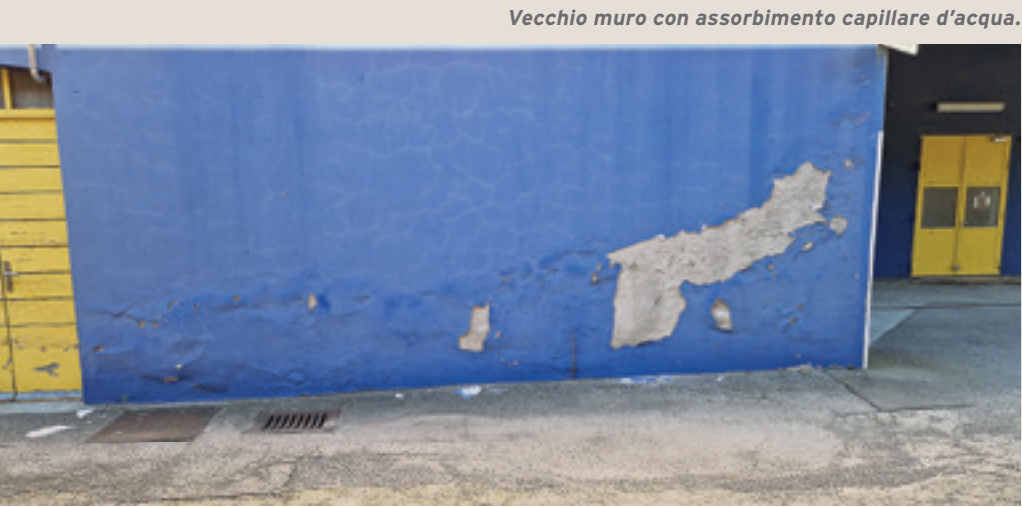
Alte Mauer mit kapillarer Wasseraufnahme.
