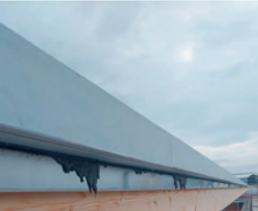
Folgen nach Verwendung eines ungeeigneten Fugendichtstoffs auf einer bituminösen Dachabdichtung.
