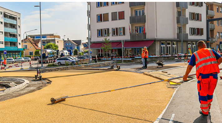
Les gravillons blancs réduisent l'accumulation de chaleur en été et améliorent la visibilité.
