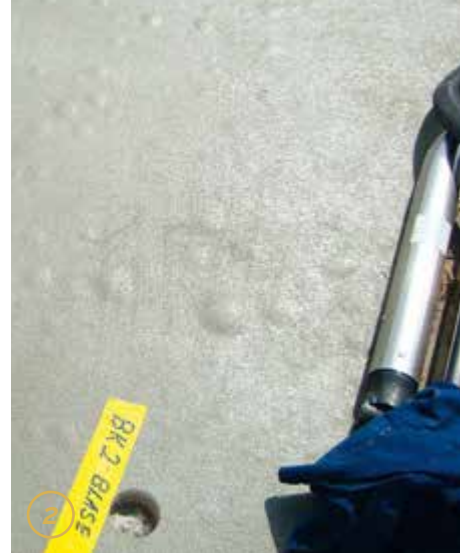
Bild 2: Osmoseblasen in einem Parkingbelag.
