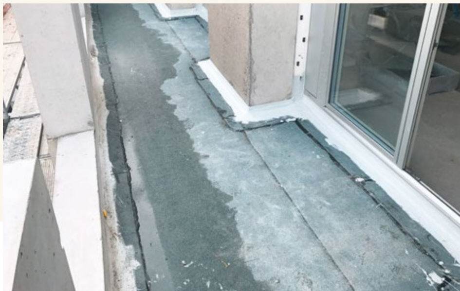
Aufbauhöhe für Splitt und Plattenbelag zu gering.
