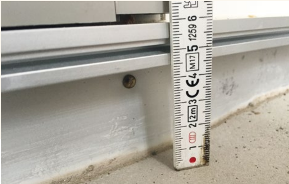
Raccord à la porte de terrasse avec surface de raccordement < 50 mm, pénétration au niveau de la surface de raccordement.
