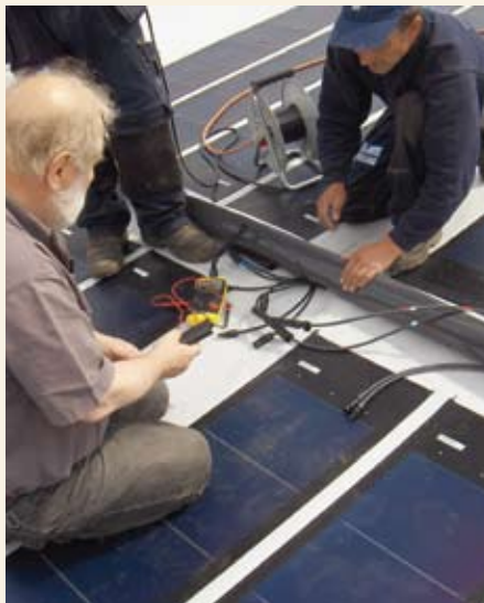
Raccords et connexions électriques.
