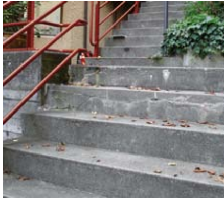
Der Treppenaufgang und die Zugangsbereiche befanden sich vor der Erneuerung in einem desolaten Zustand.
