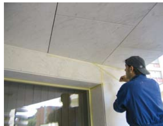
Durch das Abkleben der Fugenränder lässt sich mit einem geringen Mehraufwand eine kostspielige Sanierung vermeiden.
