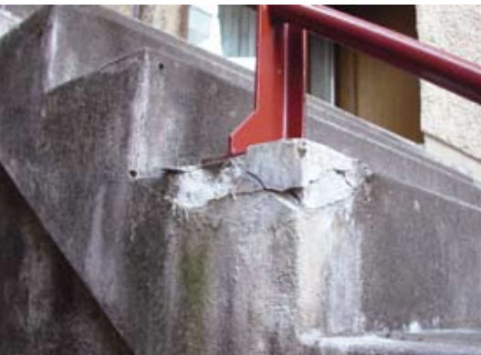
Terrassenhaussiedlung in Brugg: Treppenebereiche vor der Erneuerung.
