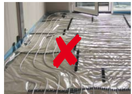
Schlecht befestigte Fussbodenheizung.
