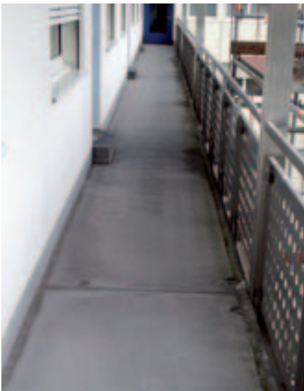
Vorher: schadhafte, undichte Laubengänge wegen Rissen in der Beschichtung.
