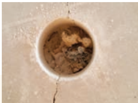
Prélèvement d'un corps d'essai d'une chape fissurée.
