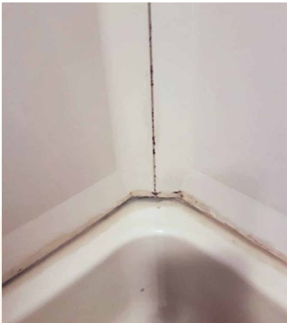
Schimmel an der senkrechten Fuge zwischen den Elementen greift auf die anscheinend sanierte Anschlussfuge über der Duschwanne über.
