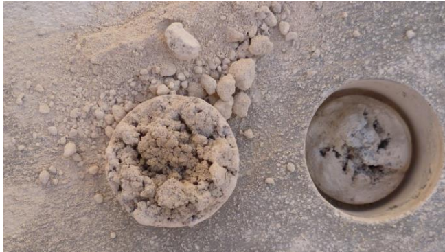
Absolut ungenügende Mörtelqualität
