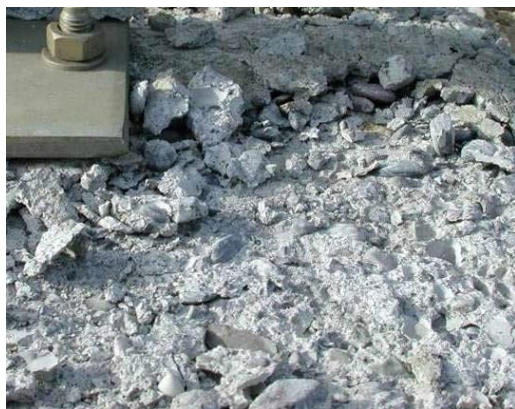
Betonbelag mit ungenügender Frosttausalzbeständigkeit: Grobe Abplatzungen und Abschälungen haben innert Kürze zu massiven Schäden geführt.
