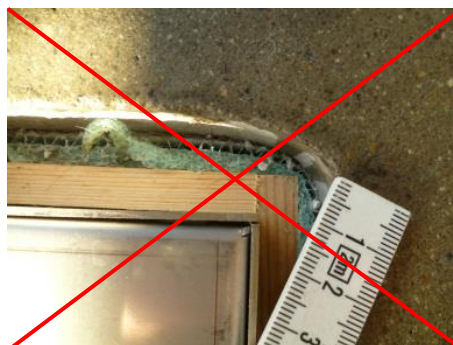
Bei so ausgebildeten Ecken kann sich der Estrich nicht mehr spannungsfrei bewegen. Risse sind zu erwarten.
