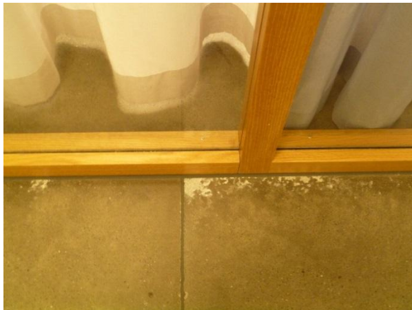
Aufsteigende Feuchtigkeit aus der Fuge eines nicht vollständig verlegereifen Fliesenestrichs.
