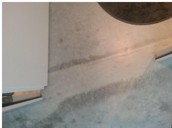
Dieser Boden war im Randbereich abgedeckt.
