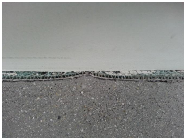
Verheerend: Randstreifen mit Heftklammern befestigt. Das wird Risse geben! (Siehe Empfehlung PAV-E 20 «Randstreifen bei Estrichen»).
