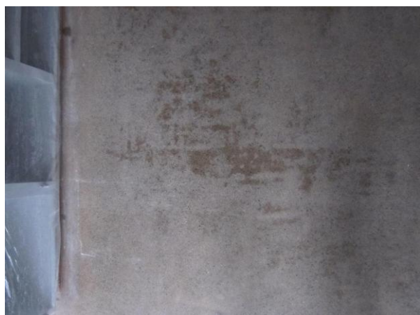
Ungleichmässiges Grundieren der Fläche. Das darf nicht sein.
