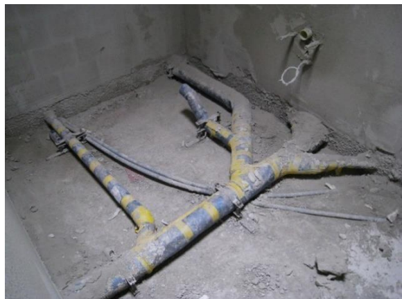
Neu- oder Umbau mit sehr vielen Installationen
