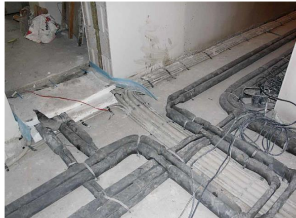
Neu- oder Umbau mit diversen Leitungen
