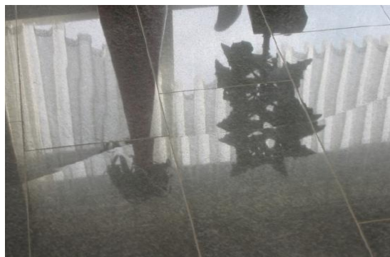
Abbildung 2: Einsenkung mit Riss im Natursteinplattenbelag im mittleren Drittel der Estrichfläche. Der Riss erscheint im Streiflicht über einer leichten Einsenkung. Die durch Druck beanspruchte Oberfläche der Natursteinplatte schiefert auf.
