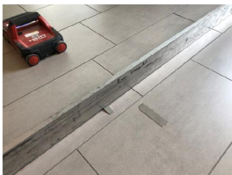
Abbildung 2: Einsenkung im mittleren Drittel der Estrichfläche ca. 7mm. Im Plattenbelag ist die Einsenkung im Streiflicht zu erkennen. Die auf Druck beanspruchten Plattenoberflächen sind jedoch (noch) nicht gerissen.
