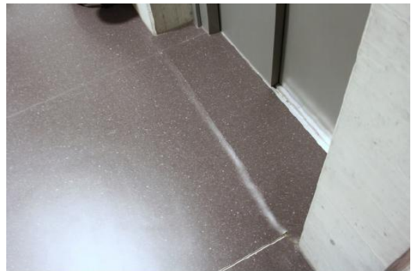
Abbildung 8: Stolperfalle vor Lift infolge Absenkung des Estrichs.
