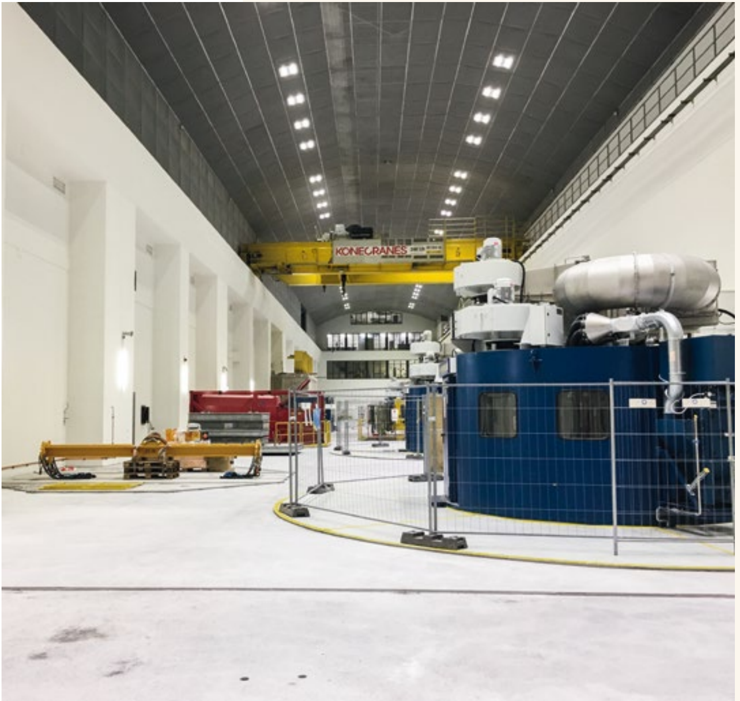
Maschinenhalle in der Bergkaverne mit fertig installierten Generatoren.
