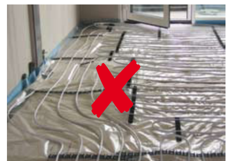
Schlecht befestigte Fussbodenheizung.
