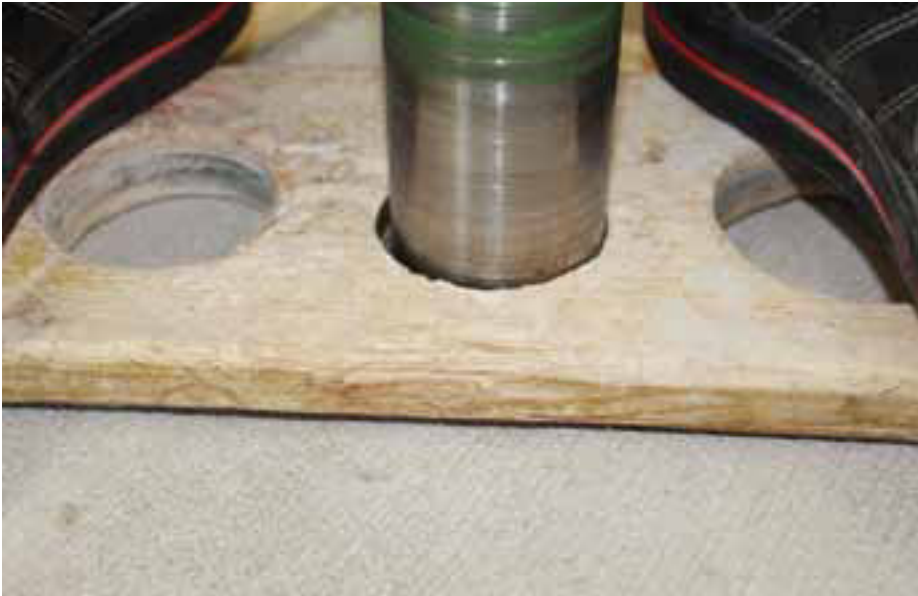
Weichen die vom Belags- und dem Estrichunternehmer durchgeführten Feuchtigkeitsmessungen zu weit voneinander ab, wird oft eine dritte, neutrale Messung angeordnet. Auf dem Bild: Entnahme einer Estrichprobe mit Hilfe eines Trockenbohrers.
