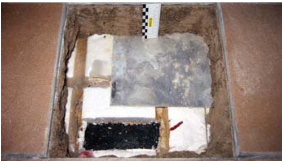
Abb. 1: Über Jahre vollständig durchfeuchteter Calciumsulfatestrich. In den Profilnuten der Dämmschicht sind noch die Spuren des Wassereintruchs sichtbar.
