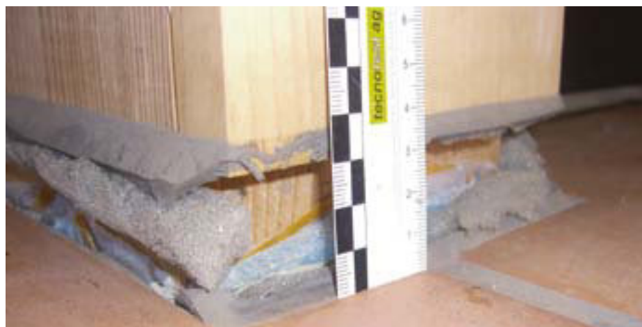
Abb. 3: Extreme Absenkung infolge Zerstörung der Dämmschicht durch Feuchtigkeit.
