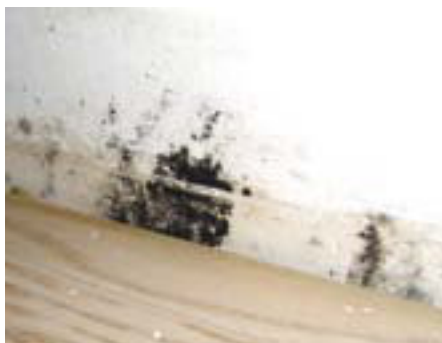
Abb. 2: Schimmelbildung unter der Sockelleiste infolge unvollständiger Trocknung.
