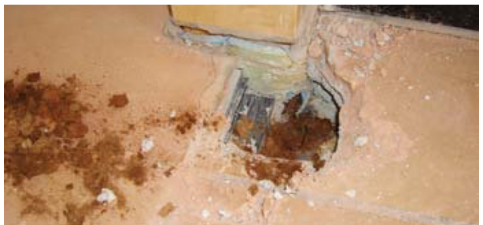
Abb. 4: Infolge Feuchtigkeit aufgelöste Dämmschicht. Die ursprüngliche Dämmschichtdicke von 80 mm ist auf rund 50 mm zusammengefallen.
