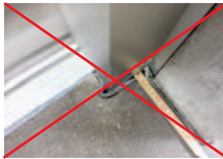
Gestauchter Randdämmstreifen: Das muss so nicht akzeptiert werden.
