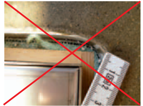
Kurve geschnitten: Der Estrich kann sich nicht spannungsfrei bewegen. Risse sind zu erwarten.
