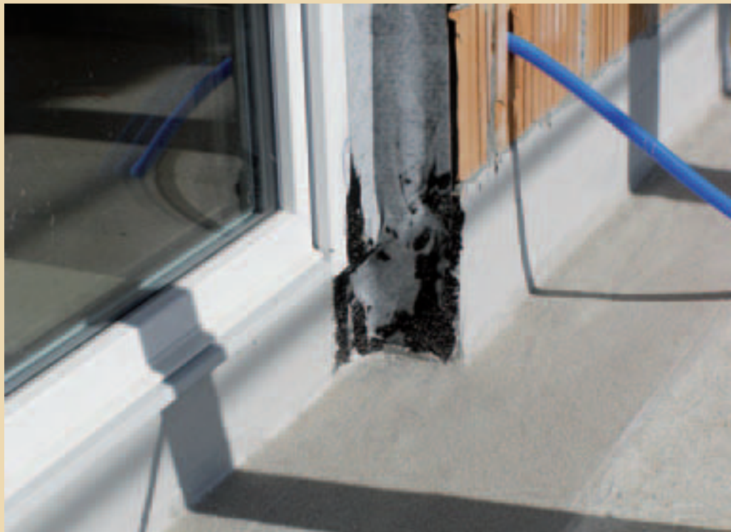
Mögliche Detaillösung: Flüssigkunststoffabdichtung über der Kragplatte mit Anschluss einer Wasserabweisfolie (dampffoffen, sd -Wert ca. 20 m).
