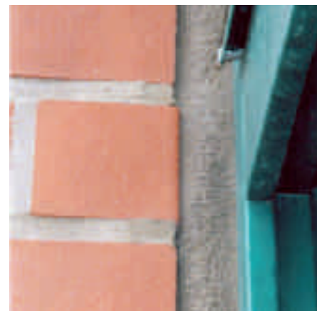
Ungenügende Komprimierungsgrade sind an der verwitterten Oberfläche zu erkennen.
