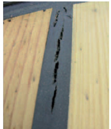
Bei Überdehnung einer Fuge reisst die Dichtungsmasse in sich selber...
