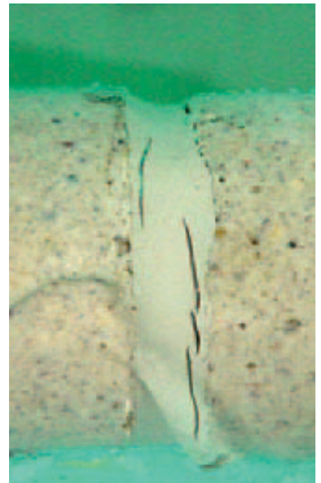
Risse in der Dichtungsmasse entstehen durch Abbau des Polymers in Folge UV-Strahlung, Bewegungen und Bewitterung.
