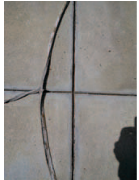
Was ist die Ursache des Versagens dieses Fugendichtstoffes?
