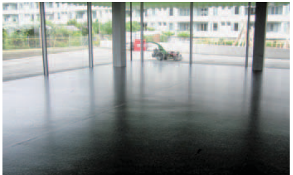
Gegen das Licht tritt die systembedingte Arbeitsfuge stärker hervor.
