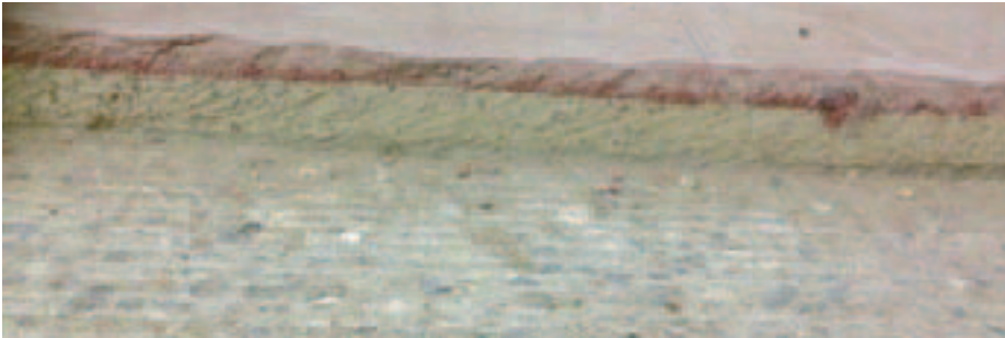
Steinholzboden mit Asbest.
