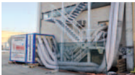
Unterdruckanlagen mit H13-Filter.
