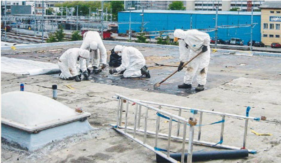
Rückbau mit Schutzanzug auf dem Flachdach. Bild aus der Broschüre «Asbesthaltige Materialien an der Gebäudehülle» der suva.
