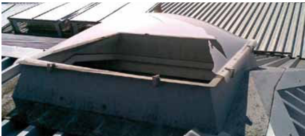
Bilder 1 und 2: Oblichter (Lichtkuppeln), durch die Personen abgestürzt sind.
