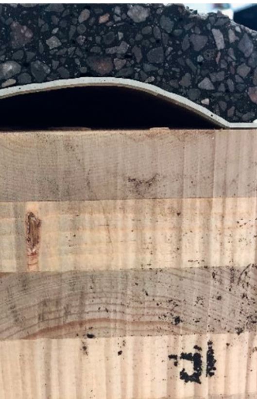
Figure 1: vue en coupe d'une cloque entre l'étanchéité PMMA et le support en bois.
