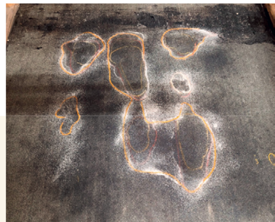
Figure 2 À droite: cloques provoquées de manière ciblée par des défauts sur une étanchéité LBP sans couche protectrice.
