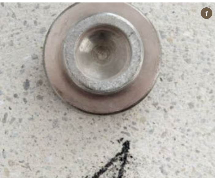
1: Sauber geschliffener und entstaubter Untergrund mit aufgeklebtem Stahlabzugstempel. Resultat genügend.
