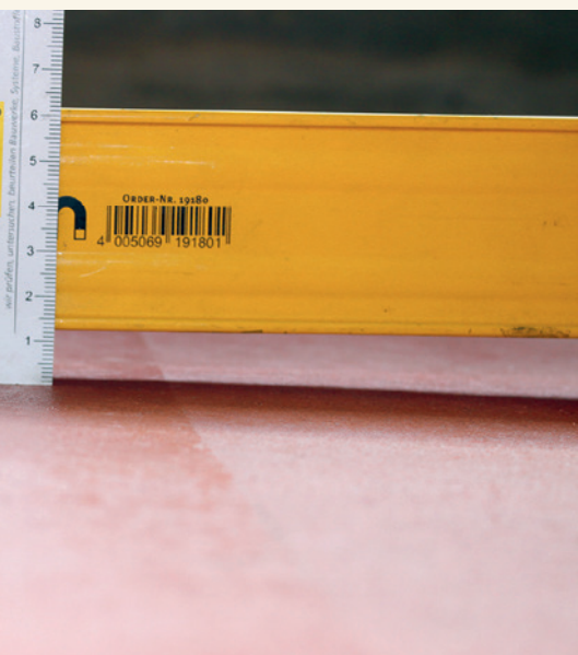
Fig. 1: Un déport de 13 mm de haut constitue un risque de trébuchement sur le revêtement.
