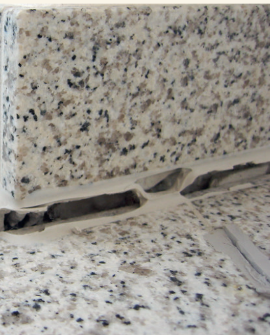
Fig. 4: Abaissement du revêtement en pierre naturelle et décollement du mastic de jointoiment.
