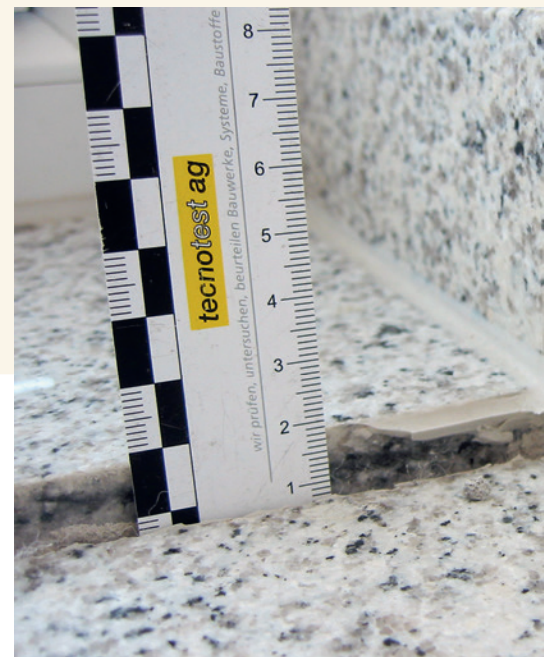
Abb. 4: Absenkung des Natursteinbelags und Ablösen der Fugendichtungsmasse.
