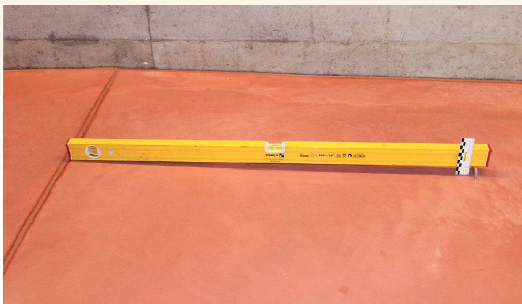
Abb. 2: Messung der Aufwölbung in einem Abstand von max. 1 m.
