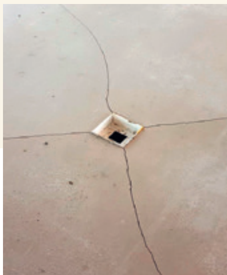
Viereckig ist immer problematischer. Hier fehlt zudem der Stellstreifen, da die Dose auf der Betondecke festgeschraubt ist.
