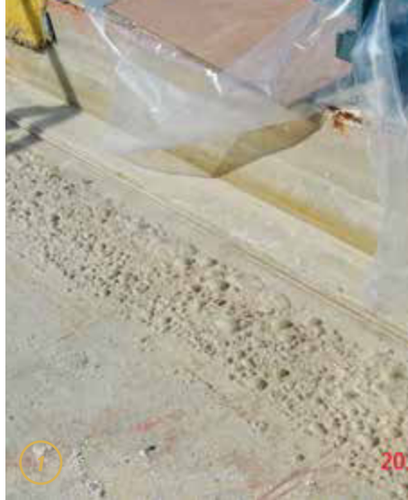
Bild 1: Osmoseblasen im Randbereich einer Flachdachabdichtung aus Flüssigkunststoff. Randbereich und Dachfläche wurden zu unterschiedlichen Zeitpunkten abgedichtet.
