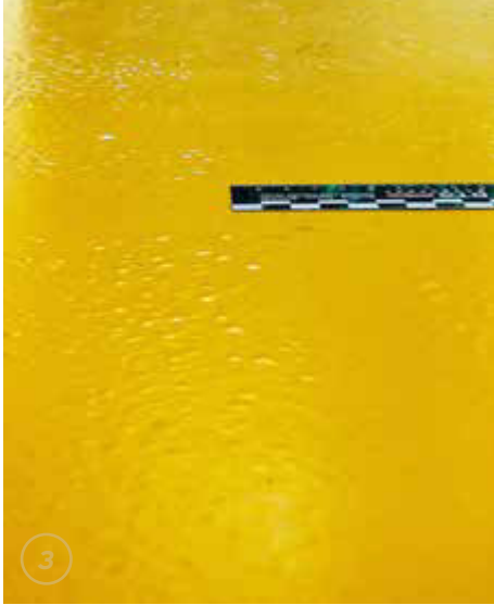
Bild 3: Osmoseblasen in einem Bodenbelag. Der Betonuntergrund ist auf dem Erdreich aufliegend.
