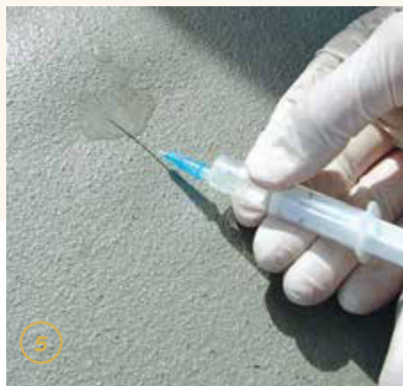
Bild 5: Osmoseblasen sind mit einer Flüssigkeit gefüllt, beim Anstechen einer Osmoseblase tritt oder spritzt diese aus.
