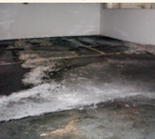
De l'eau qui pénètre à travers des endroits non étanches et qui gèle à l'intérieur du bâtiment suite aux températures basses.
