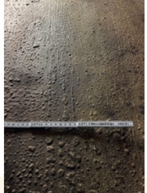
Cloques en ligne sur les parois.
