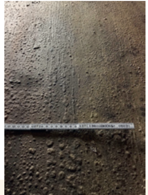
Cloques en ligne sur les parois.
