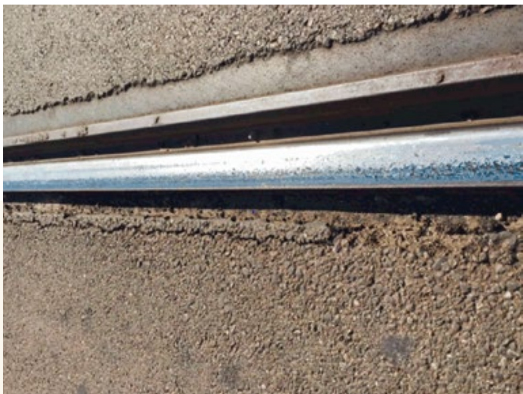
Joint en scellement à froid enlevé - asphalte à côté du joint déchiré.
