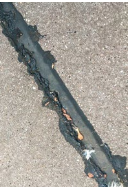
Incompatibilité d'un joint à scellement à froid avec des résidus de joints à scellement à chaud.
