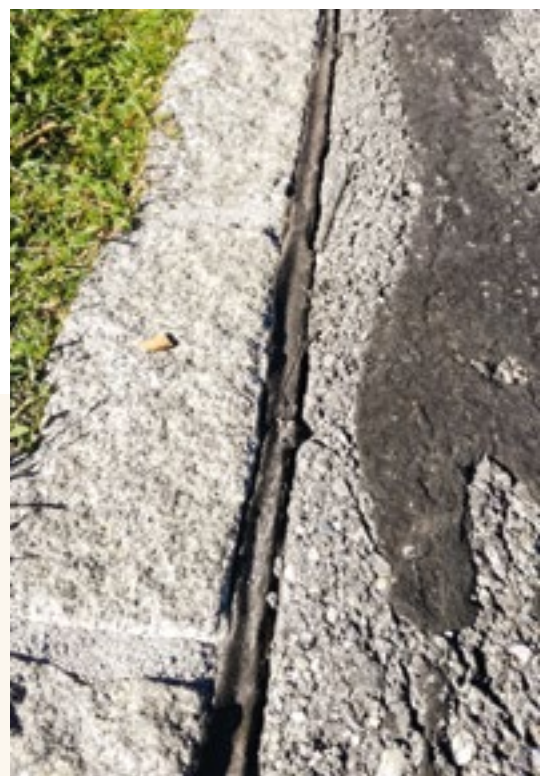
Joint de raccord aux bordures à base de bitume - problème d'étanchéité.
