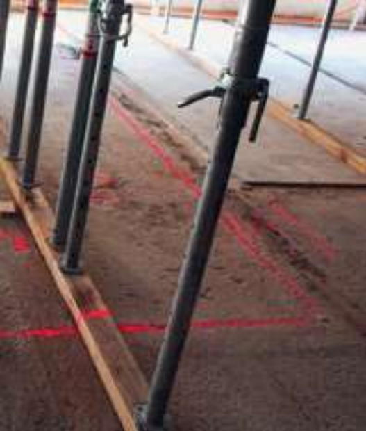
Tracé du décapage du béton avec indication de la profondeur en centimètres.
