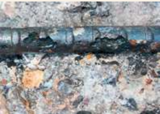
Corrosion par piqûres prononcée de la 4 e couche d'armature.
