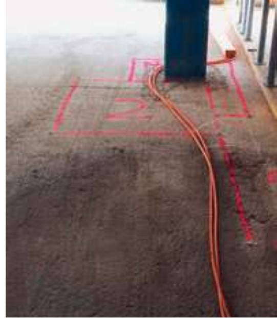
Angezeichneter Betonabtrag mit Tiefenangabe in Zentimetern.
