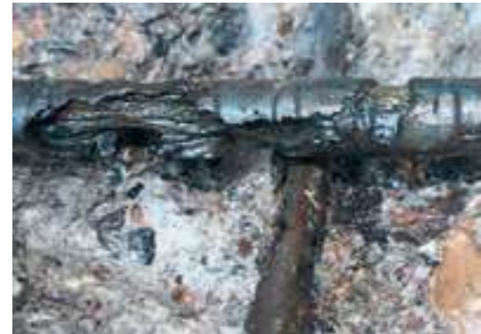
Ausgeprägte Lochfrasskorrosion der 4. Bewehrungslage.
