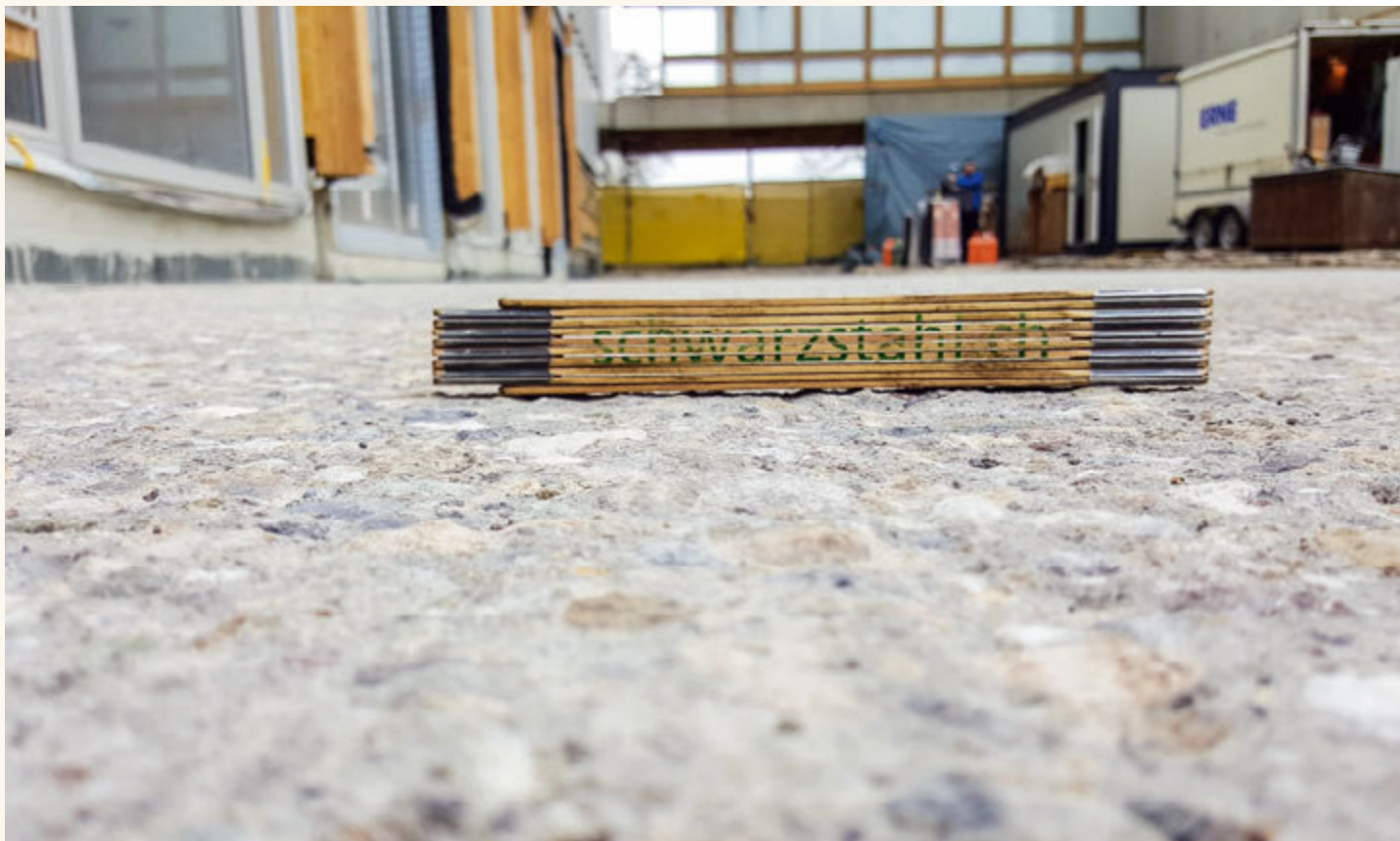
Surface béton après fraisage fin (et grenailage) avec un tambour de fraisage fin profondeur de rugosité 2,4 mm.
