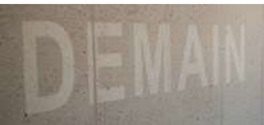
Illustration 4: Inscription sur mur en béton.
