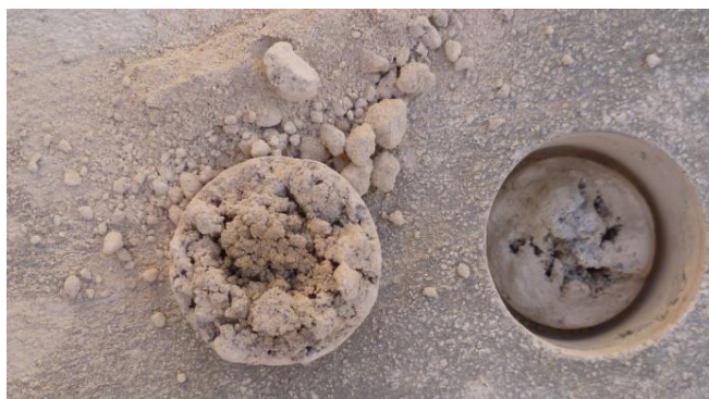
Qualité insuffisante du mortier
