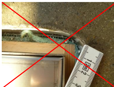
Des angles formés de cette sorte empêchent la chape de se dilater sans contraintes. Des fissures sont à prévoir.
