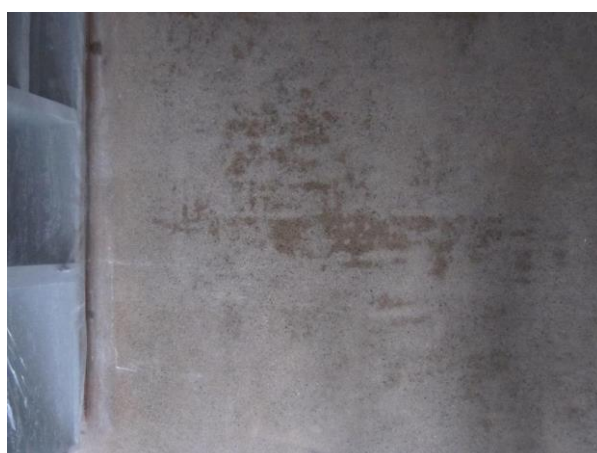
Enduisage irrégulier du fond de la surface. Cela ne doit pas se produire.
