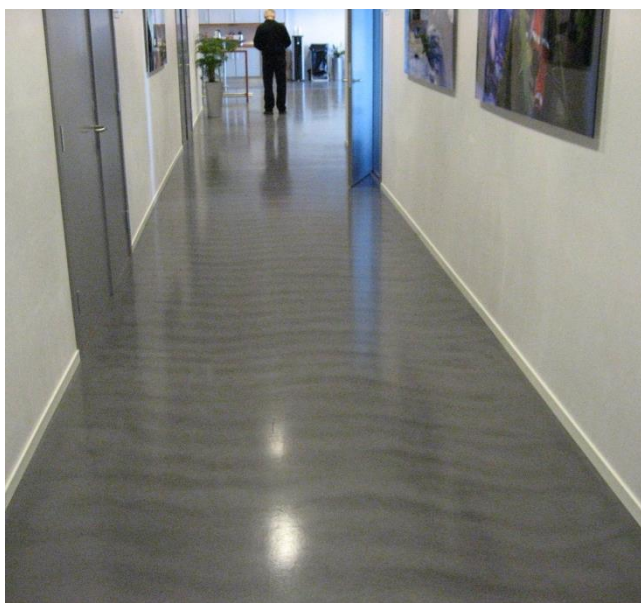
Revêtement de sol design avec les traces typiques de la mise en œuvre.
