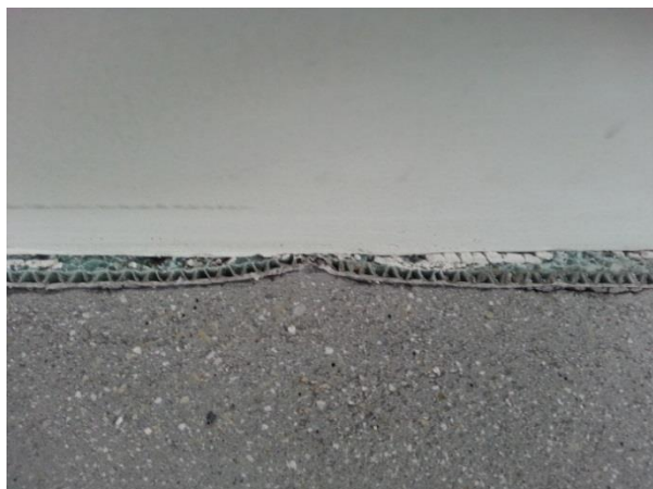
Désastreux: bande de rive fixée avec des agrafes. Des fissures sont garanties! (Voir Recommandation PAV-E 20-2014 « Bandes de rive pour chapes ».)
