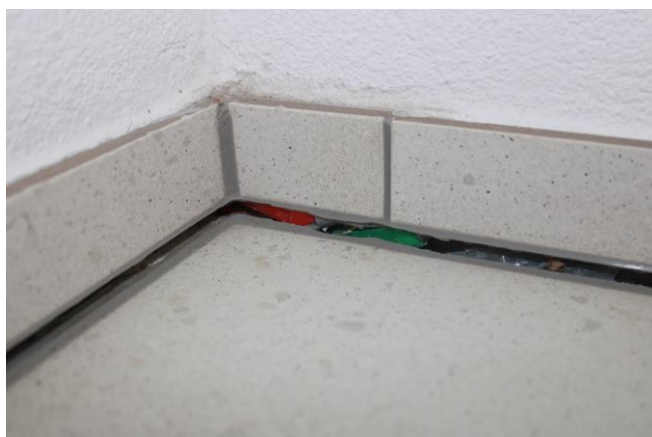
Figure 1: Décollement du revêtement de sol de la plinthe
