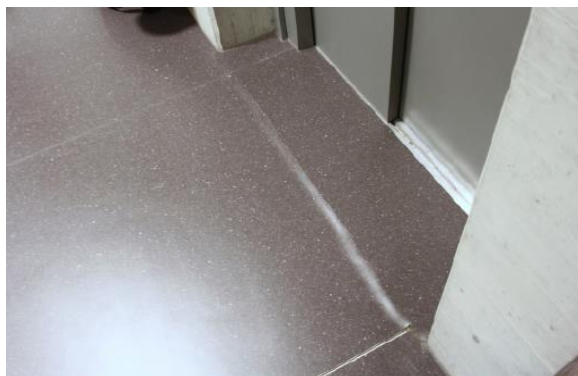
Figure 8: Risque de trébuchement devant l'ascenseur dû à l'affaissement de la chape
