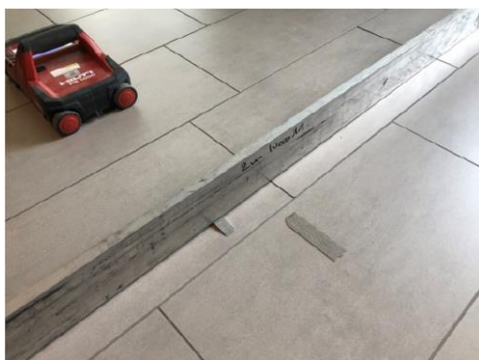
Figure 2: Affaissements dans le tiers central de la surface de la chape d'environ 7 mm. L'affaissement est visible dans le revêtement en lumière rasante. Cependant, les surfaces soumises à la pression ne sont pas (encore) fissurées.
