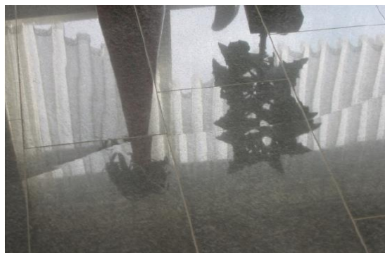
Figure 2: Affaissement avec fissuration du revêtement dans le tiers central de la surface de la chape. La fissure apparaît en lumière rasante au-dessus d'une légère dépression. La surface du revêtement, sollicitée par la pression, est inclinée vers le haut.
